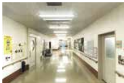
【廊下のLED照明】 高輝度でありながら、消費電力は抑えられています
