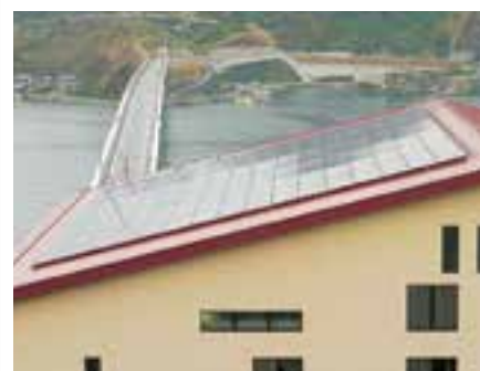
太陽光発電パネル（汚泥再生処理センター）
